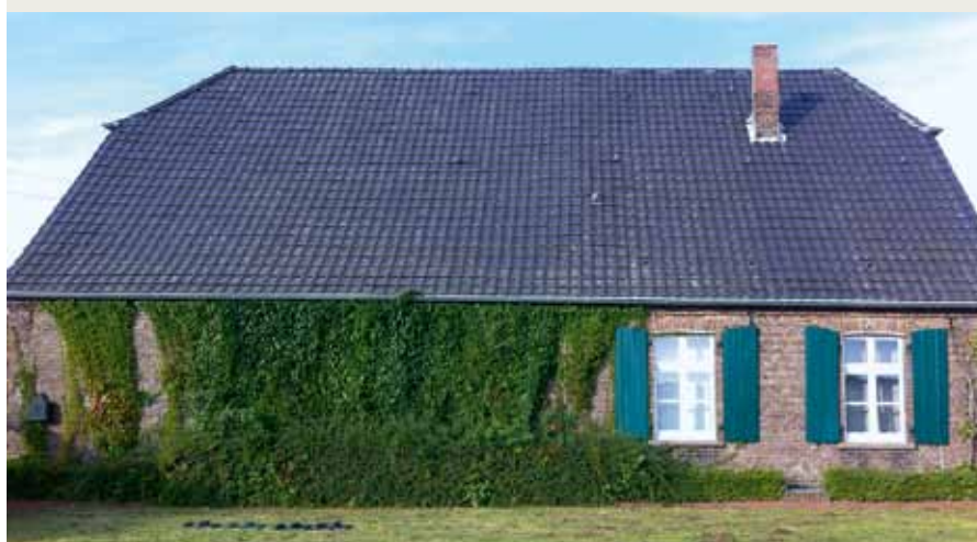
Vor Beginn der Arbeiten: Ursprünglich hatten sich lediglich ein paar Ziegel gelöst. Bei der Begutachtung durch den Dachdecker stellte sich heraus, dass Ziegel und vorhandene Lattung völlig marode waren.
