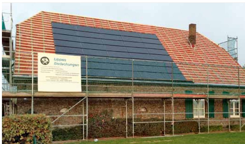
Das Feld aus 40 Einzelmodulen ist eingedeckt. Im Anschluss folgt das Beidecken der Dachziegel.
